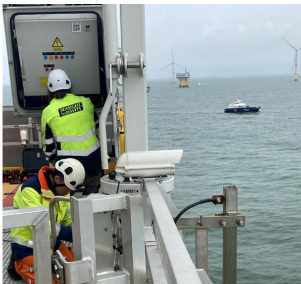
Photo. 3 : boîtier étanche d'O-GEO installé sur éolienne, vue éloignée (EDF RF, 11/04/2025)
