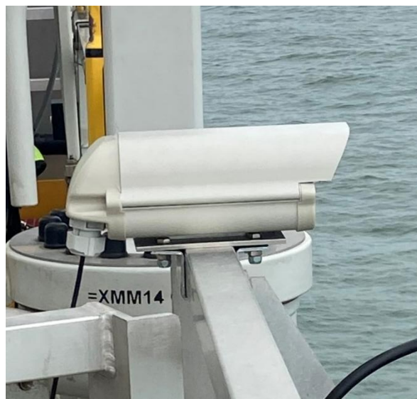
Photo. 4 : boîtier étanche d'O-GEO installé sur éolienne, vue proche (EDF RF, 11/04/2025)
