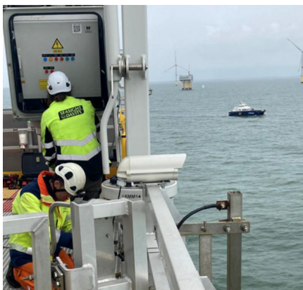
FIGURE 18 : BOITIER ÉTANCHE D'O-GEO INSTALLÉ SUR ÉOLIENNE, VUE ÉLOIGNÉE (PBG, 11/04/2025)
