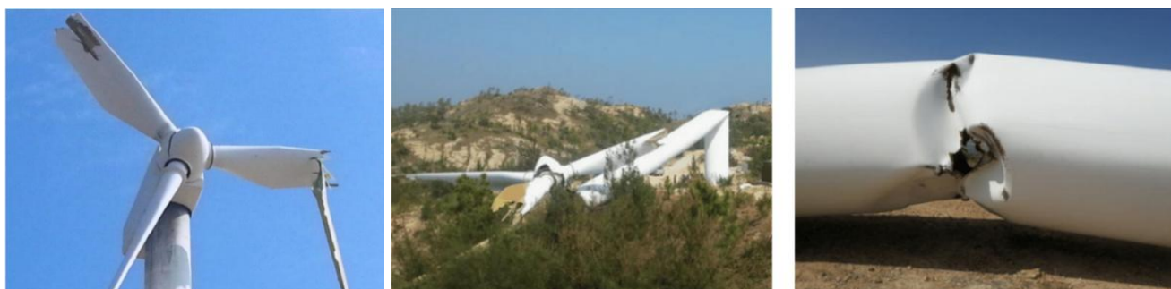
Image 66 Dommages aux pales et aux tours d'une éolienne Vestas V4/660 du parc éolien Honghaiwan (Chine) causés par le typhon Usagi en 2013 (Source : Jiawen Li et al)
