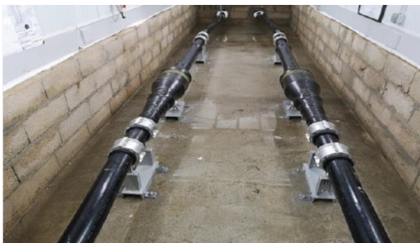
Chambres de jonction terrestres ≈ 1km
