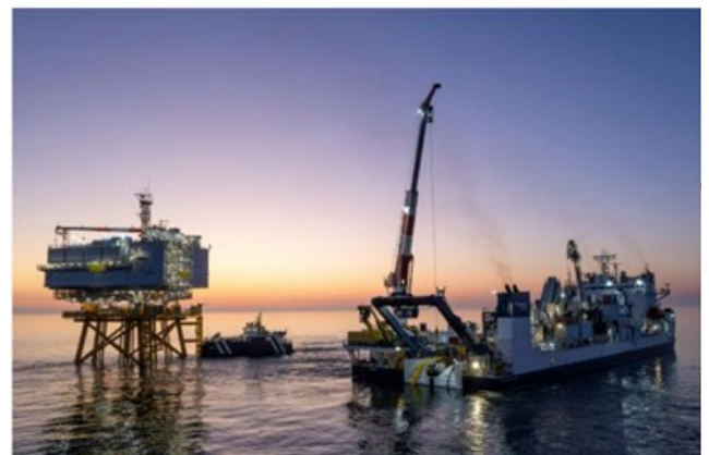
Poste électrique en mer. Source : RTE
